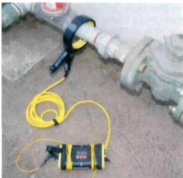
Рисунок 10: Индукционные клещи, подсоединенные к проводнику.
